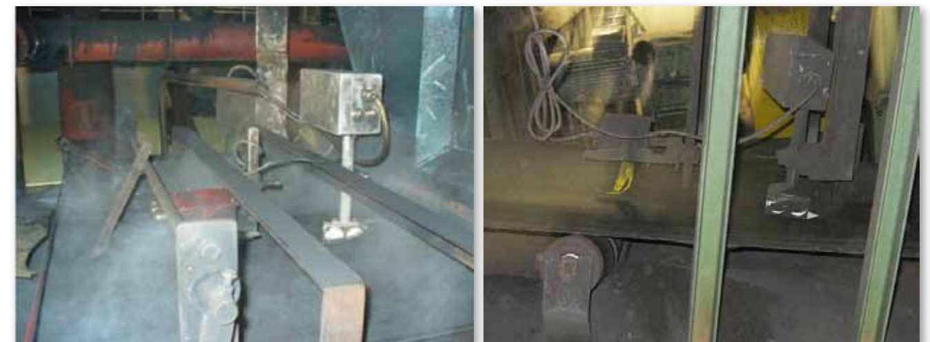
Instalaciones típicas de puntos de medición en la entrada y salida del refrigerante
