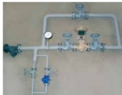
Dampfdosiereinheit mit elektro-pneumatischem Ventil DD - fertig verrohrt
