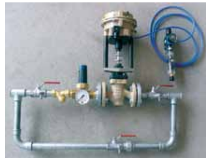
Wasserdosiereinheit mit elektro-pneumatischem Ventil WD - fertig verrohrt
